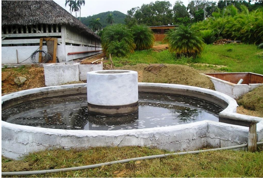
Fig. 7: Biodigestor con sistema de extracción de lodos sedimentables (sección superior derecha) y tanque de compensación encima de la cúpula.
